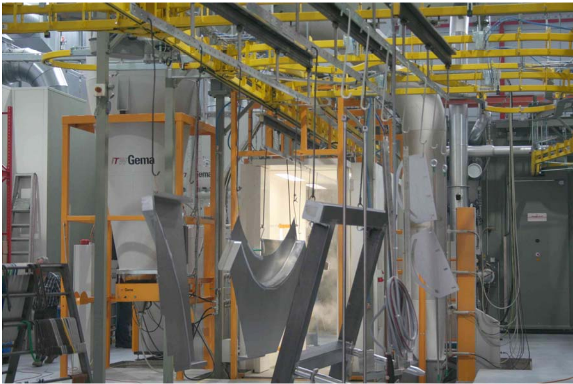
Pulverbeschichtungsanlage – „Bahnhof“ der zu beschichtenden Teile
