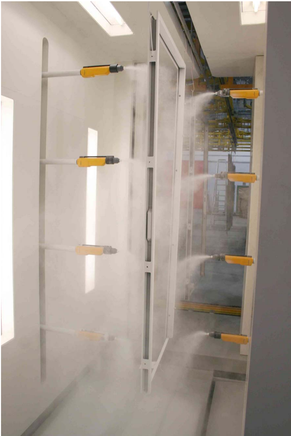
Pulverbeschichtungskabine mit Stahlzarge, die beschichtet wird.
